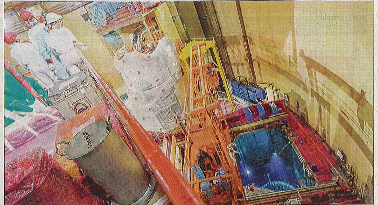
Lors de la quatrième visite décennale du réacteur n° 1 de la centrale nucléaire du Tricastin (qui en compte quatre), en juin 2019, pour passer le cap des 40 ans. Archives photo Le DL/Fabrice ANTÉRION
